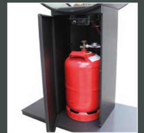
Schówek na butlę z gazem propan-butan, otwarte drzwiczki z podłączoną butlą gazową
